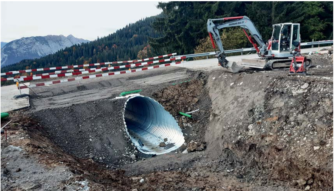
Die eingebaute Viehunterführung in der Alp Rischi
