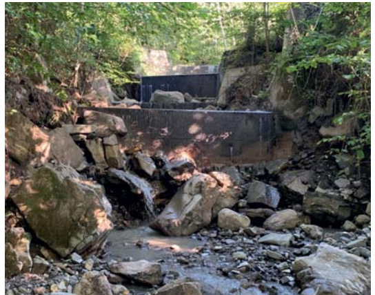
Unterspülte Sperre Schlimbach, Talen
