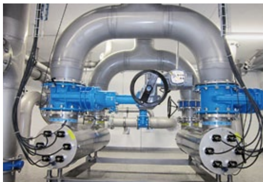
UV-Desinfektionsanlage Reservoir Gubermatt
