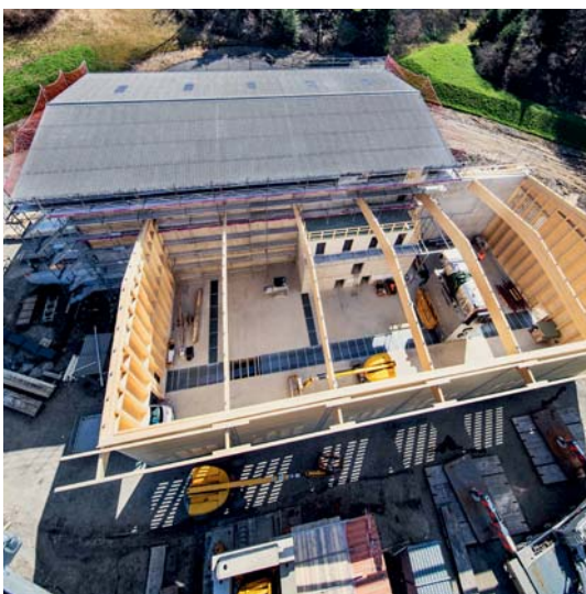
Heizzentrale Wärmeverbund Sarnen
